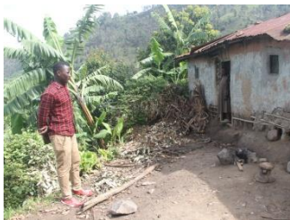
Fred vor seiner Hütte, die wegen Einsturzgefahr unbewohnbar ist.
